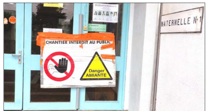
Pas d'entrée scolaire cette fois: cette maternelle est en cours de déflochage
