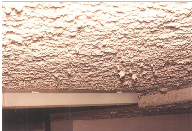
Ecole de Bertaccio à Lugano: les pelotes d'amiante se détachent et tombent constamment du plafond floqué sur le sol.
