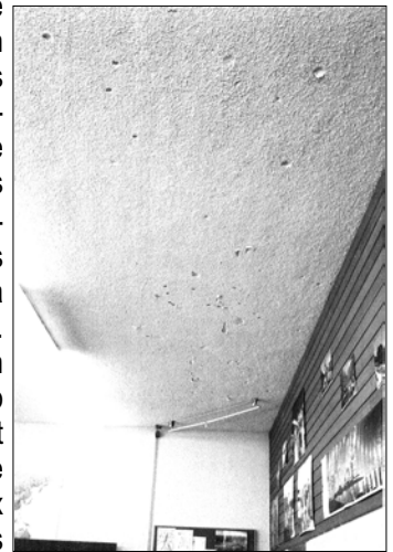
Impacts au plafond d'une salle de classe floquée.
